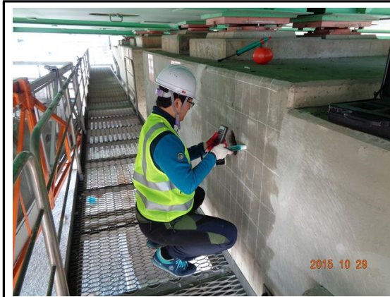
위 치 교각 내 용 철근부식도 시험
